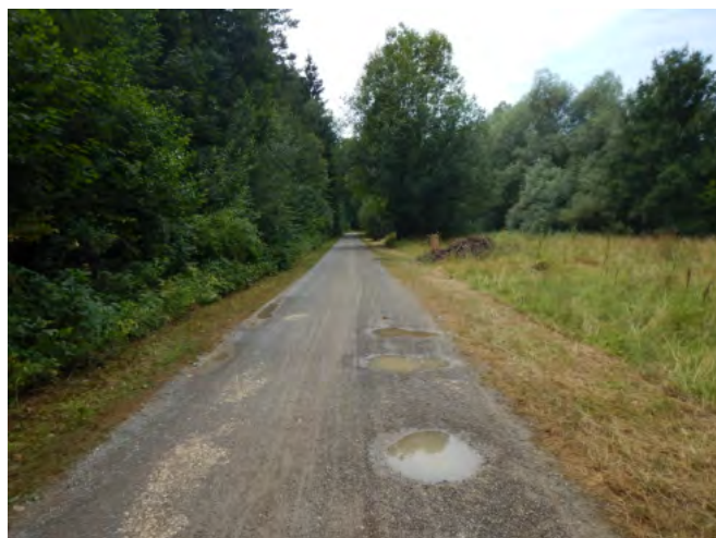
Abb. 1: Negativbeispiel: Verdichtete wassergebundene Decke mit Pfützenbildung und schlechter Wasserdurchlässigkeit
