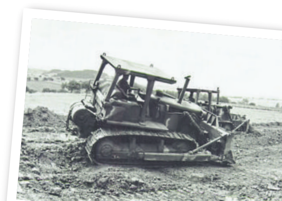
Beim Bau des Ausweichplatzes in Kirchhasel 1986 waren auch Pioniere der Hünfelder US-Patenschaftskompanie im Einsatz, um die Erdarbeiten zu erledigen.
