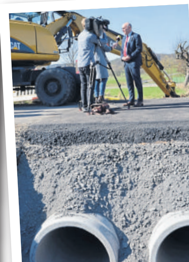
Hohe Aufwendungen erfordert der Schutz vor Starkregenereignissen auch in Roßbach. Bereits 2018 wurde der Durchlass unter der Landesstraße mit hohem Kostenaufwand vergrößert. Damals interessierte sich auch das Fernsehen für dieses Thema.
