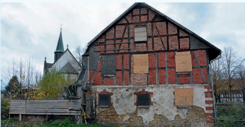
Das verfallene Ruinengrundstück in der Ortsmitte von Roßbach soll geräumt werden. Stattdessen haben Bauherren dort künftig die Möglichkeit, bis zu vier Wohnbaugrundstücke zu erwerben.
