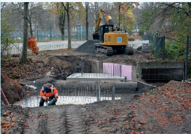
Für die Fußgänger- und Radwegebrücke im Hünfelder Bürgerpark an den Tennisplätzen werden im Herbst die neuen Fundamente hergestellt. Dazu muss der Bachlauf der Hasel provisorisch verrohrt werden. Auf das Fundament wird ein Brückenbogen aus dauerhaftem Aluminium gesetzt.
