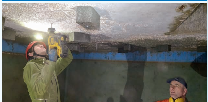
Der alte Wasserbehälter bei Mackenzell wird zum Fledermausquartier umgebaut worden. Das ist wichtig: Denn im Raum Hünfeld sind bisher nur wenige Winterquartiere für Fledermäuse vorhanden. Fotograf: Stefan Zaenker
