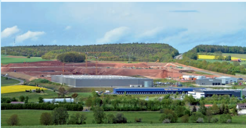
Die riesigen Erdbewegungen auf der Großbaustelle des künftigen Logistikzentrums von Tegut im Gewerbe- und Logistikgebiet Hessisches Kegelspiel sind fast abgeschlossen.
